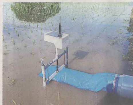
水門が自動開閉する給水ゲート
